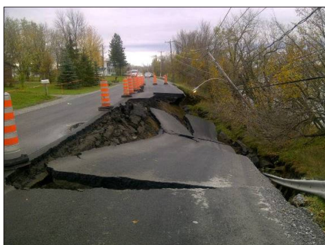
Figure 1 – Route emportée par un glissement de terrain
