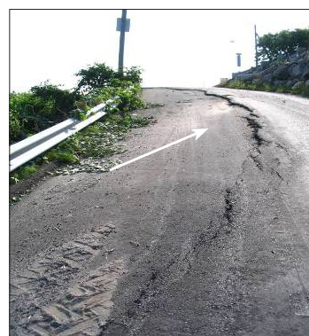
Figure 2 – Signe précurseur de glissement de terrain (fissure en arc de cercle avec déplacement vertical)
