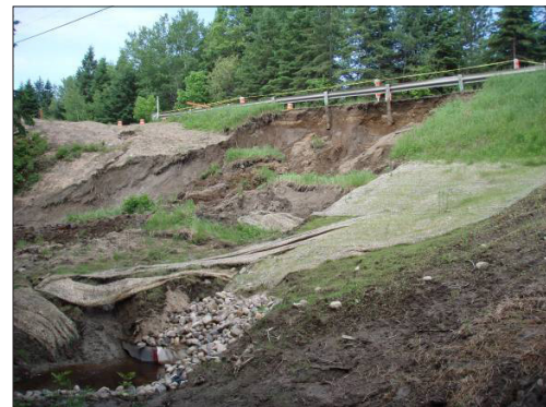
Figure 4 – Glissement de terrain survenu à la suite d'une excavation à la base d'une pente argileuse pour la réfection d'un ponceau
