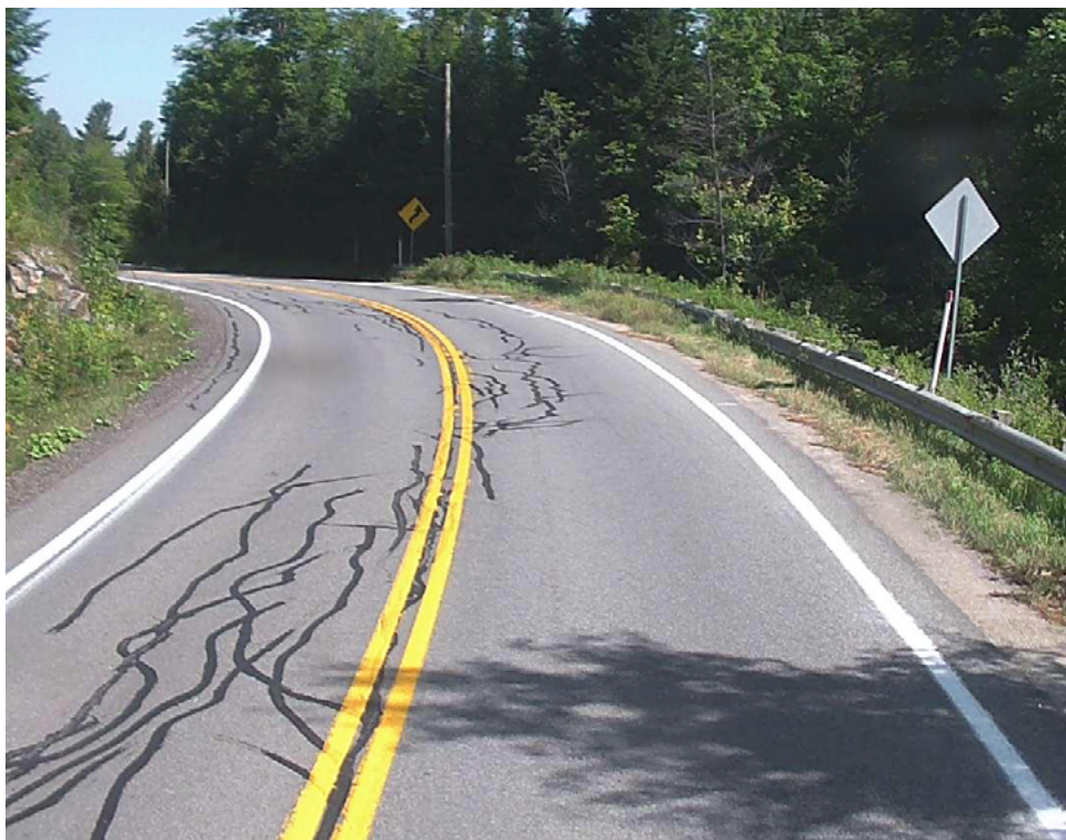
Figure 1 – Secteur comportant trop de produit de scellement de fissures.
