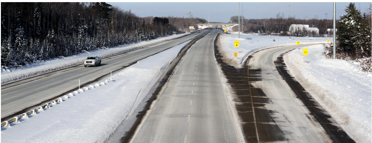
Figure B.2 – Coloration blanche de la chaussée causée par l'excès de sel de voirie à la suite de l'évaporation de l'eau
