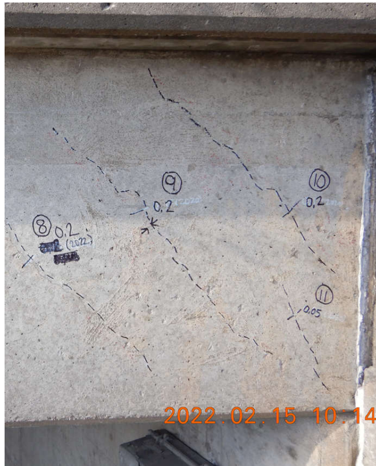
Figure 4 : Exemple de Fissures de cisaillement relevées sur les structures
