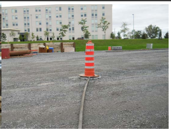
Puisard non relié au réseau
